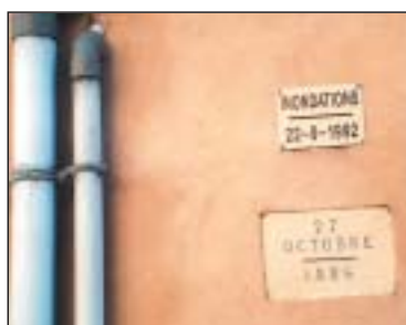
Repères de crues utiles à la mémoire de l'inondation et participant à la culture du risque
