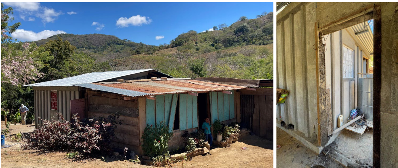
Los beneficiarios con recursos, pueden realizar ampliaciones, pero requieren conocimientos para no debilitar la estructura.
