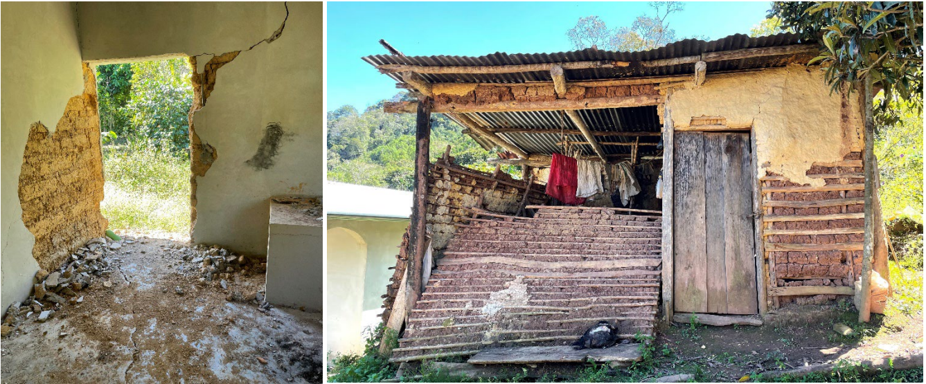
Daños comunes en los edificios locales. Algunos edificios quedaron completamente destruidos.
