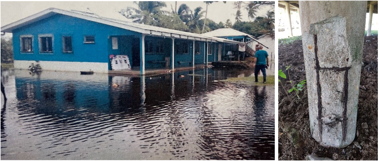
Situación: inundaciones y vientos fuertes debido a los huracanes y vulnerabilidad previa de las estructuras por falta de mantenimiento
