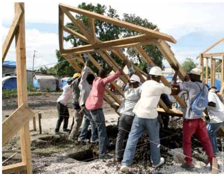
Des ouvriers et des menuisiers de la Croix-Rouge et du Croissant-Rouge construisent un logement de transition à l'Annexe de la Mairie, Port-au-Prince.
